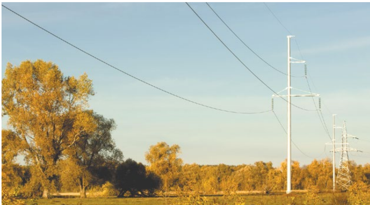
Słup rurowy linii wysokiego napięcia
