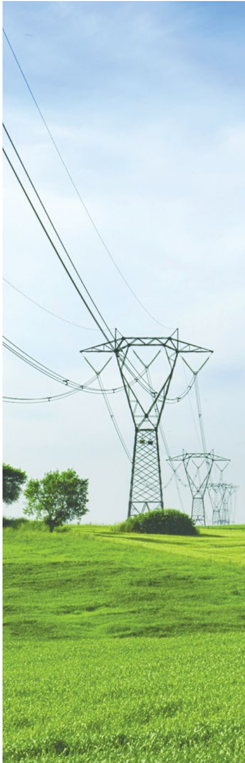
Linia najwyższego napięcia
